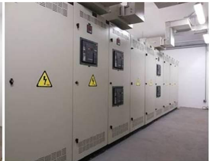
QGBT com Disjuntores Schneider e com Multimetro de Dados
