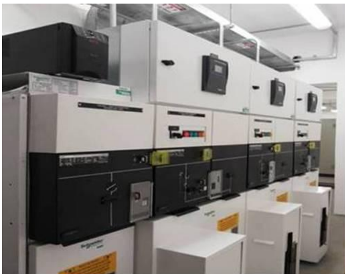
Subestação Engenhariaia 20kv - Cubiculos F6 da Schneider (01) Entrada e (03) Saídas p/ Disjuntores
