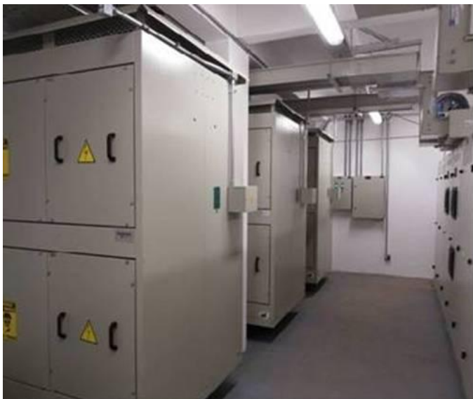
(03) Transformadores de Potência 1000kva Blindade da Schneider
